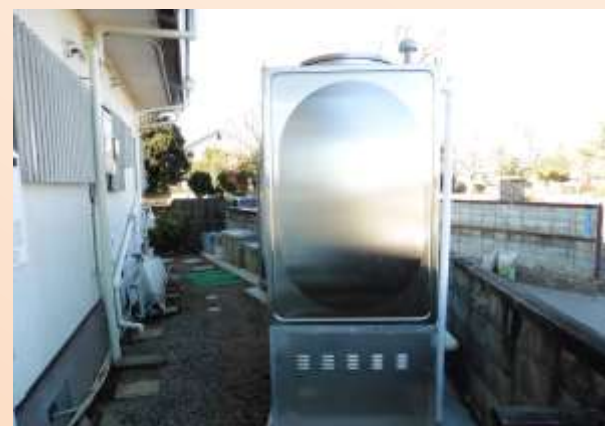
12月20日 第一面でもお知らせしたとおり、スプリンクラー工事が無事に終了しました。写真は虹の家の裏庭に設置された水を蓄えるためのタンクです。
